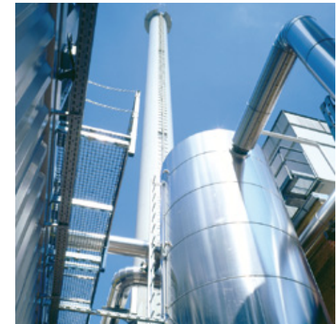
Saubere Energie: Das firmeneigene Blockheizkraftwerk spart jährlich eine Million Liter Heizöl ein.
